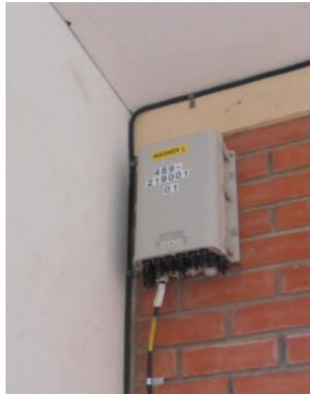
Imagen 1.7. CTO exterior 16P. Ubicación en fachada.y Splitter
