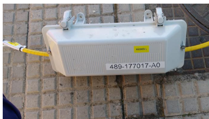
Imagen 1.6. Caja de Empalme, en su interior Splitter 1
