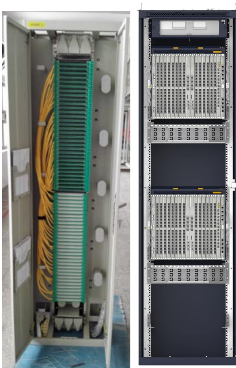
Imagen1.1: Izquierda Armario ODF, derecha armario con OLT
