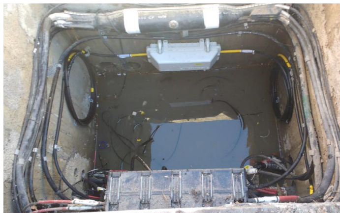
Imagen 1.5. Caja de Empalme, ubicación en arqueta
