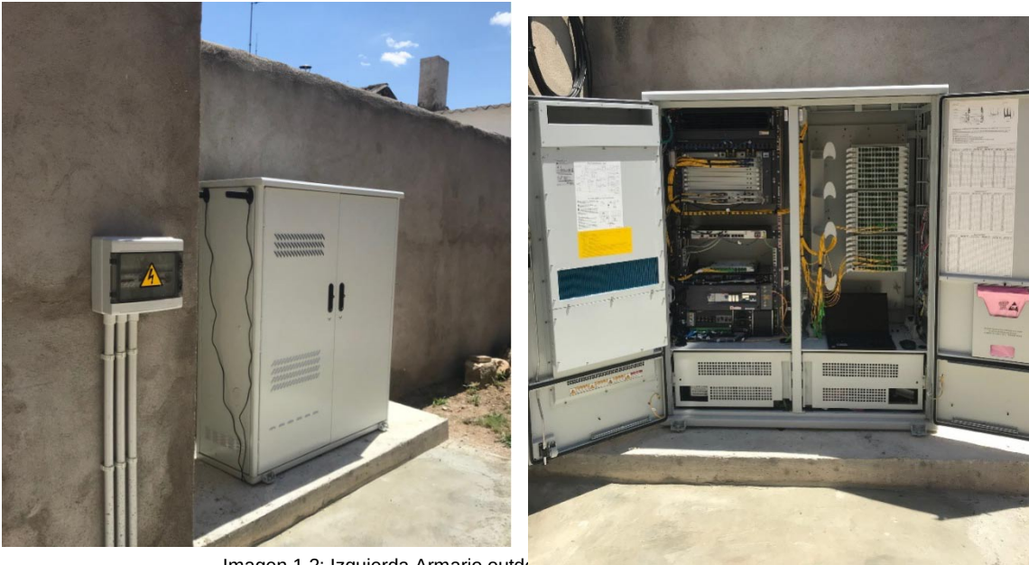
Imagen 1.2: Izquierda Armario outdoor cerrado en bancada. Derecha Armario outdoor abierto.
