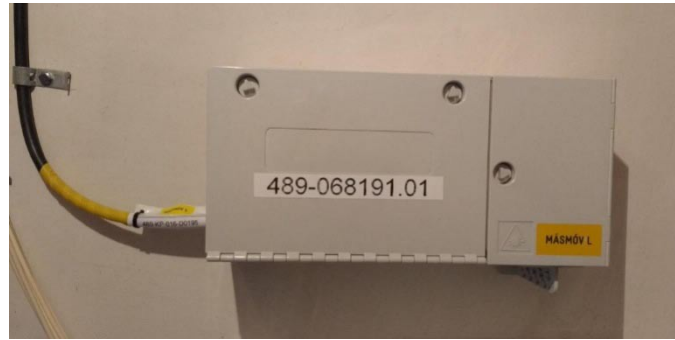
Imagen 1.7. CTO interior. Detalle exterior.
